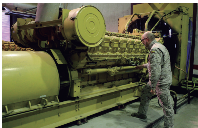
Uno de los cinco grupos electrógenos de la Agrupación que proporcionan electricidad a la base si se produce un corte de suministro. A la derecha, radar móvil para controlar la velocidad de los vehículos en el interior de la base.
